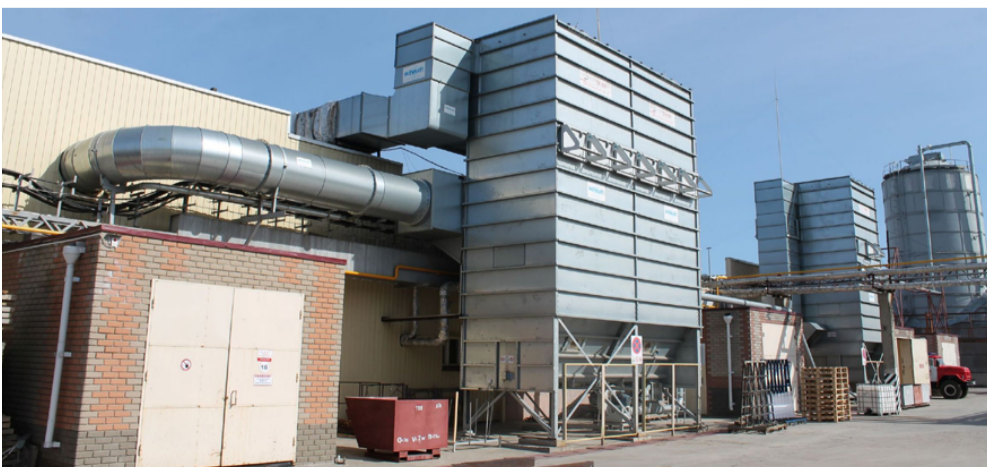
Система возврата тепла при вентиляции деревообработки
