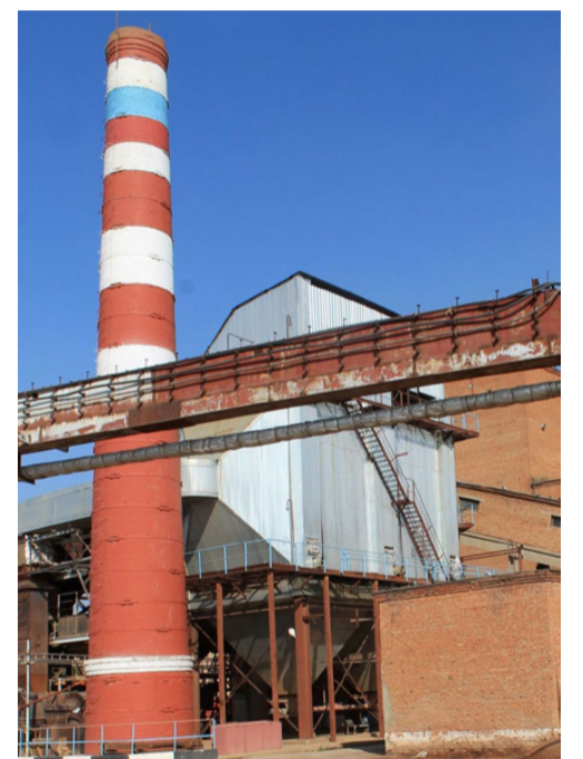
Цех керамзитового гравия. Электрофильтр
